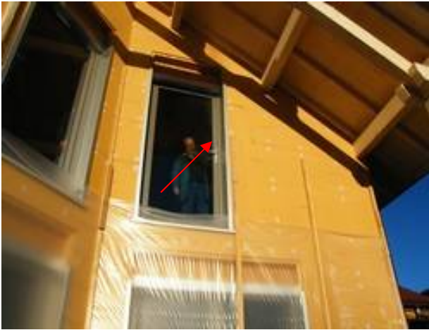
02 Infiltrations entre ouvrants et dormants des trois portes fenêtres
