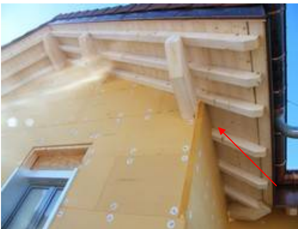
04 Petite fuite à la liaison mur / rampant
