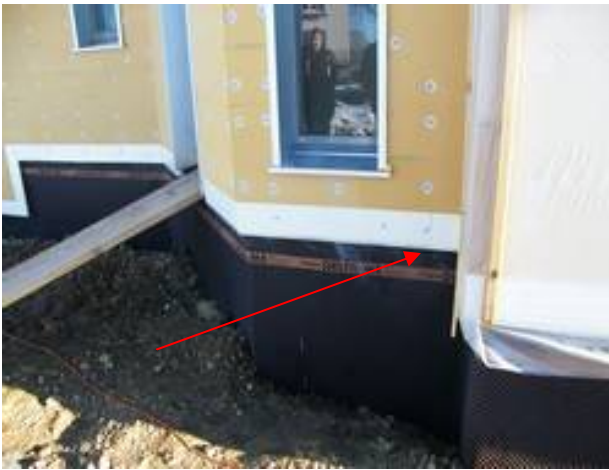
03 Petite infiltration par la lisse basse des murs de refend
