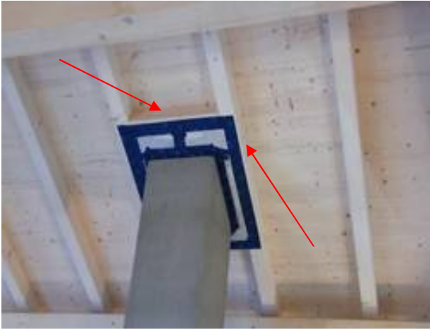
05 Petite infiltration au niveau du chevêtre du conduit de cheminée
